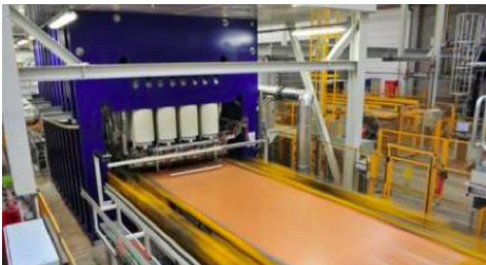
Prensa KT 700 en las instalaciones de Egger en Rambervillers, Francia. Foto: Siempelkamp
